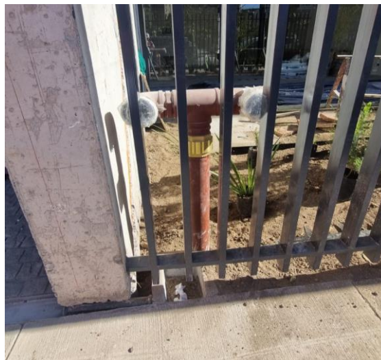
Fotografía N° 5 Red Seca Exterior edificio
