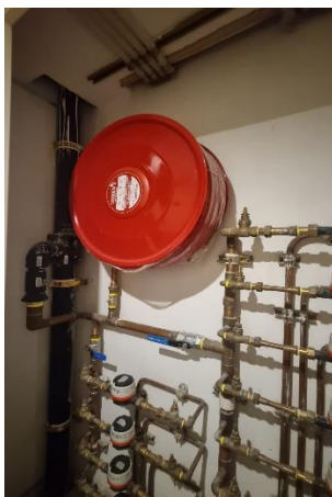
Fotografía N°3 Carrete Red Húmeda
