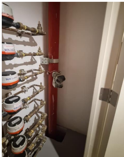
Fotografía N° 4 Red Seca Interior edificio
