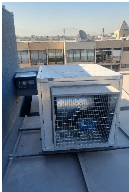
Fotografía N.º 13 Presurizador
