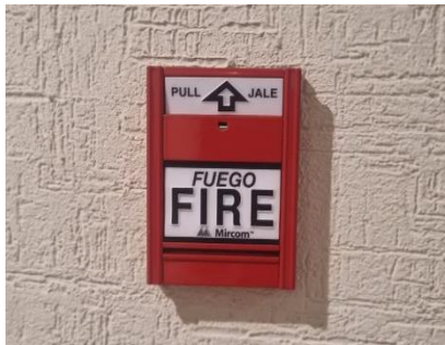
Fotografía N°7 Palanca de Emergencia
