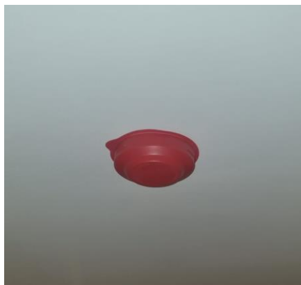
Fotografía N° 9 Sensor de Humo
